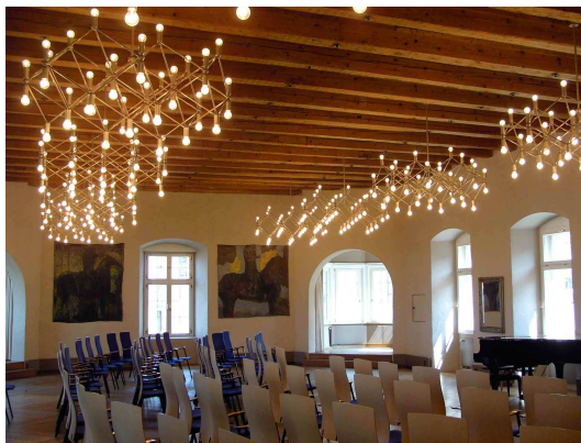
Bild: Deckenbeleuchtung im Fuggersaal der Burg Stettenfels.
