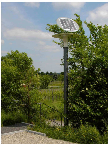
Bild: Solarbetriebene Außenleuchte im Hotel Rappenhof.
