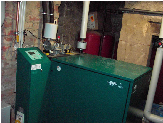
Bild: BHKW im Pfälzer Hof / Bad Rappenau.
