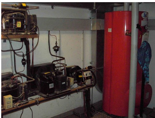
Bild: Wärmerückgewinnung im Hotel Rappenhof.
